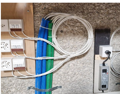
Anschlüsse für Beleuchtung und Geräte in einem Buffet.
