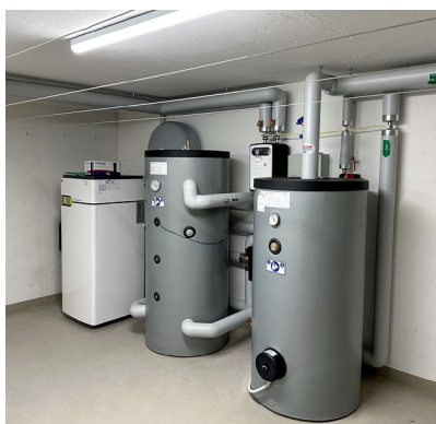
Wärmepumpe mit Speicher und Warmwasserboiler.
