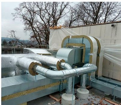
Dachzentrale der Lüftungsanlage.
