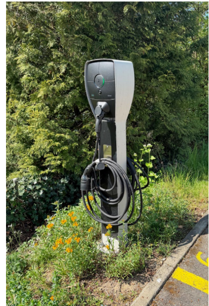
E-Ladesäule der neuesten Generation.
