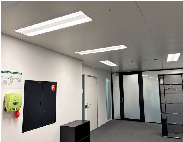
Büroräumlichkeiten mit neuer Deckenbeleuchtung.
