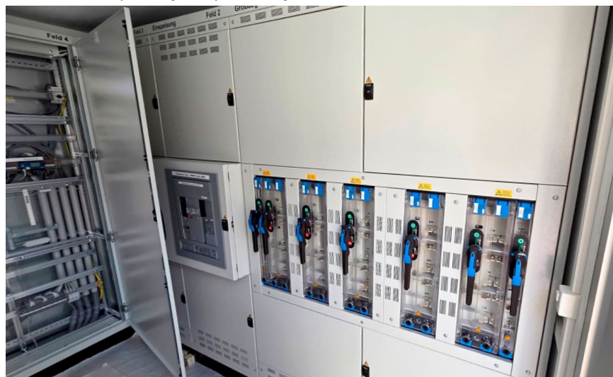
Die neue Niederspannungs-Hauptverteilung.
