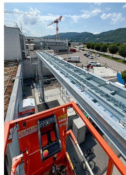
Rohrbrücke vom Dach zur Verteilkabine.
